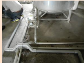
萬丹四維國小進水及出水系統之管線交接複雜
